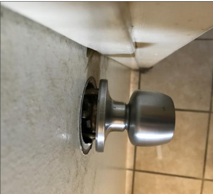
Broken bedroom doorknob
