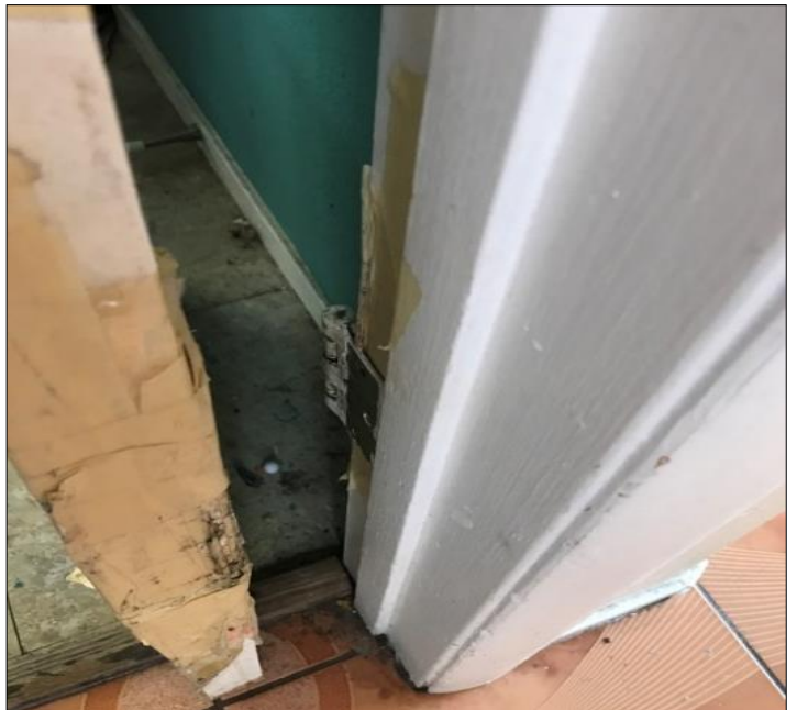
Broken bedroom door
