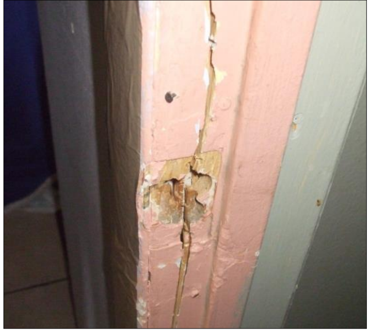
Broken bedroom doorframe
