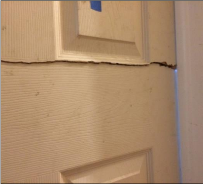
Broken bedroom door
